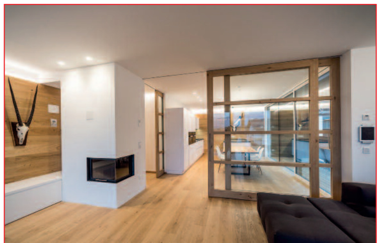
Ein Gira-Homeserver übernimmt die gesamte Steuerung und Kontrolle der installierten KNX-Anlage, die von der Raumklimatisierung über die Beleuchtung bis hin zur Musikanlage beinahe alle SmartHome-Funktionen abdeckt.
